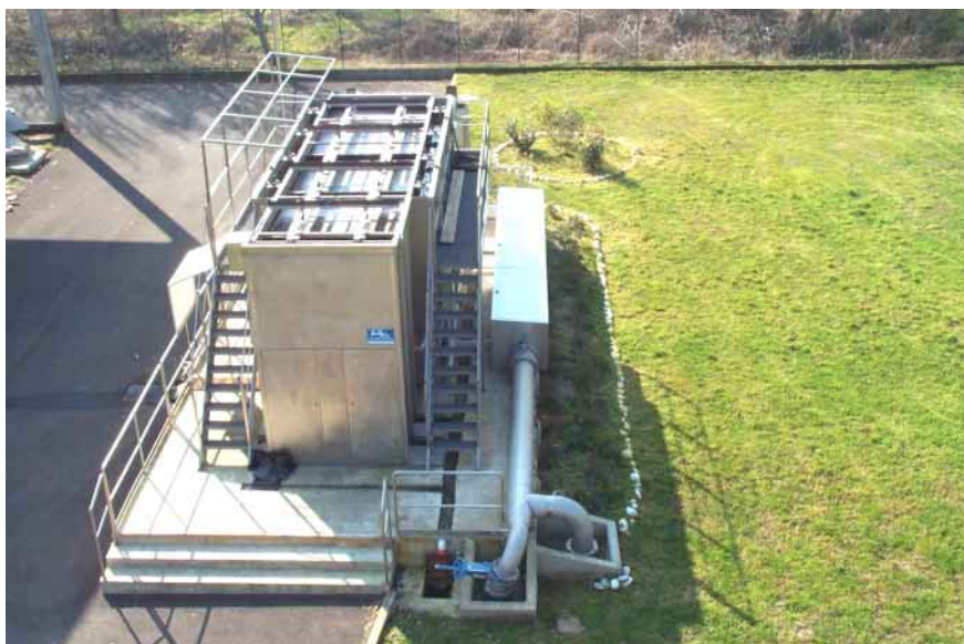
L'impianto di Depurazione di Lucca dove è installato un Flottatore Lamellare con capacità di trattamento pari a 350.000 l/h, realizzato dalla Bio Mass Impianti S.r.l.
