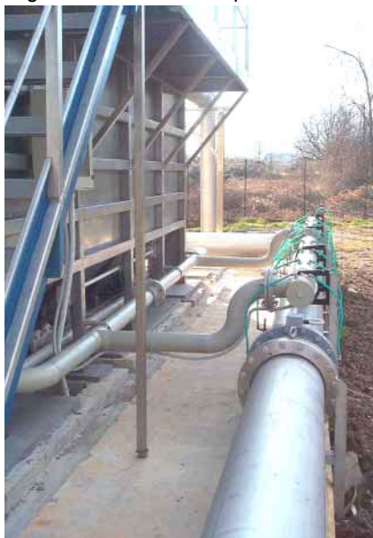
Linea di condizionamento con flocculazione ed iniezione della miscela satura di aria dissolta
